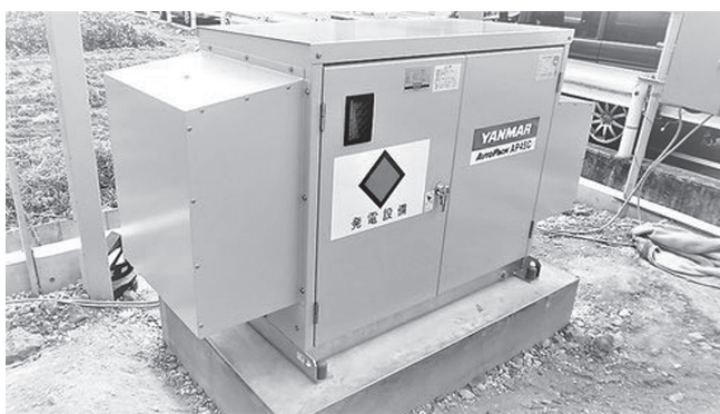
非常用自家発電設備のサンプルです。これを有屋山上の親局に設置できれば、台風時でも安定的に放送することができます。実現に向けて、議会からも後押ししていきます。
